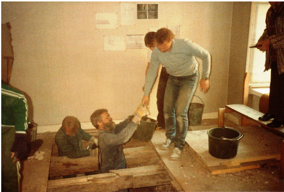
Källaren under 16B grävs upp - hål i golvet i lägenhet 26A på bottenvåningen! Utrymmet under är "luckan" på tio fot mellan 16A- och 16B-husens grundmurar som omnämns i kapitlet om när husen byggdes. Foto Olev Nöu
